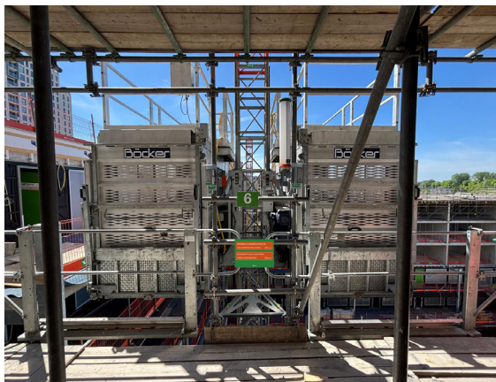
Figuur 59: afbeelding verdiepsingsnummer lift + verlichting
